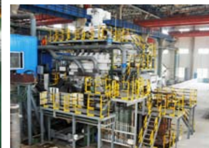
20吨真空感应炉
