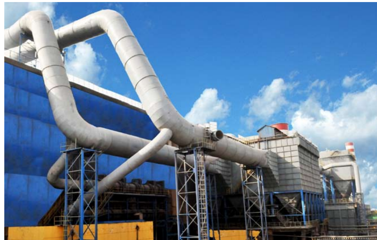
▲ 公司第一炼钢厂除尘装置
